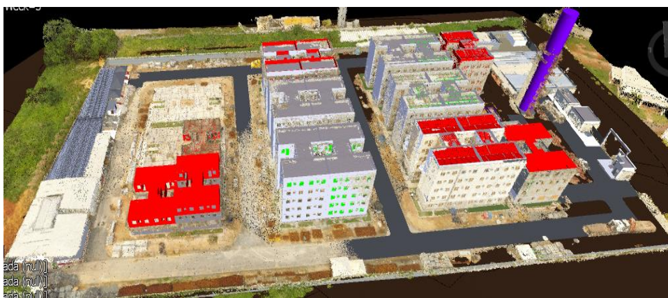
Figura 26 - Exemplo de modelo sobreposto (nuvem de pontos e BIM) com os indicadores de cores para identificação do status de progresso em simulação 4D
