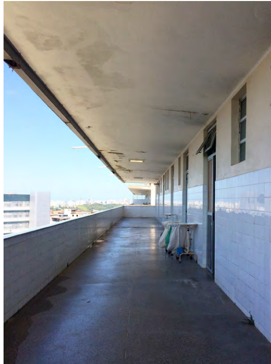
Figura 109 Ala norte, solário do quarto pavimento criado pelo balanço da laje, ancorada na zona central do edifício. Fonte: tirada pela autora, 2018
