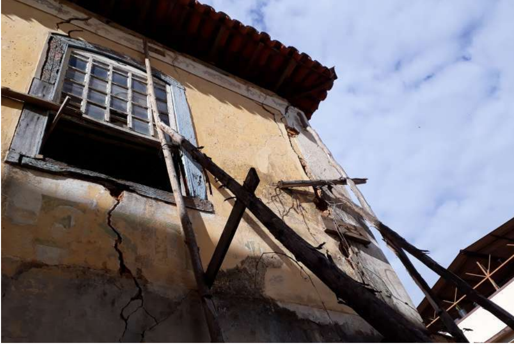
Caderno 2 Foto 45: Trincas e rachaduras na fachada noroeste no pavimento superior.
