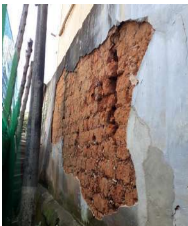
Figura 159 - Rachadura no Pavim. Térreo
