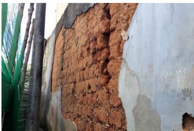
Figura 229 - Rachadura na fachada sudoeste
