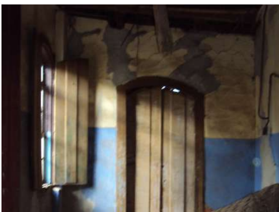
Figura 160 - Deformação no portal, esquadria e na vedação
