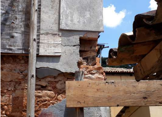
Caderno 2 Foto 53: Perda de reboco emboço no cunhal entre as fachadas nordeste e noroeste. Detalhe à Nordeste.
