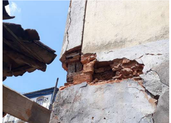
Caderno 2 Foto 54: Perda de reboco emboço no cunhal entre as fachadas nordeste e noroeste. Detalhe à Noroeste.
