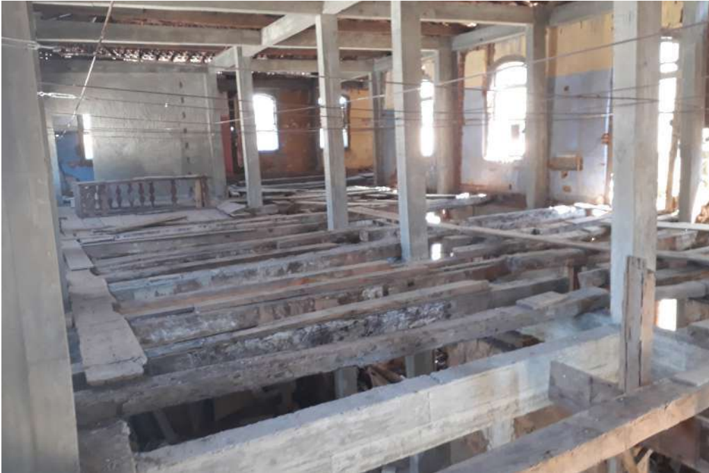
Caderno 2 Foto 37: Vista do primeiro Pavimento. Aos fundos paredes er- guidas em tijolos furados ao fim do ano de 2015
