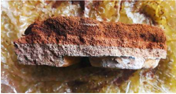
Figura 172 - Placa de reboco desprendida
