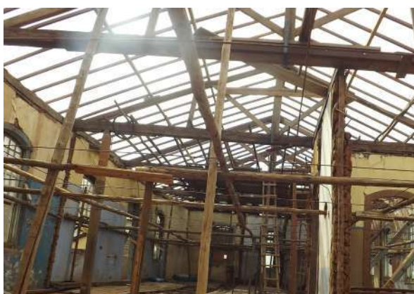
Figura 189 - Vista interna do Casarão Selaria Estrela (Já com as paredes do piso superior demolidas e sem telhas na cobertura)
