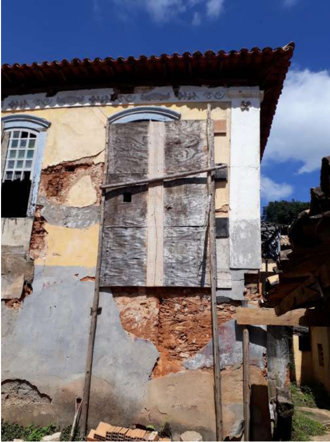
Caderno 2 Foto 47: Danos na fachada nordeste.
