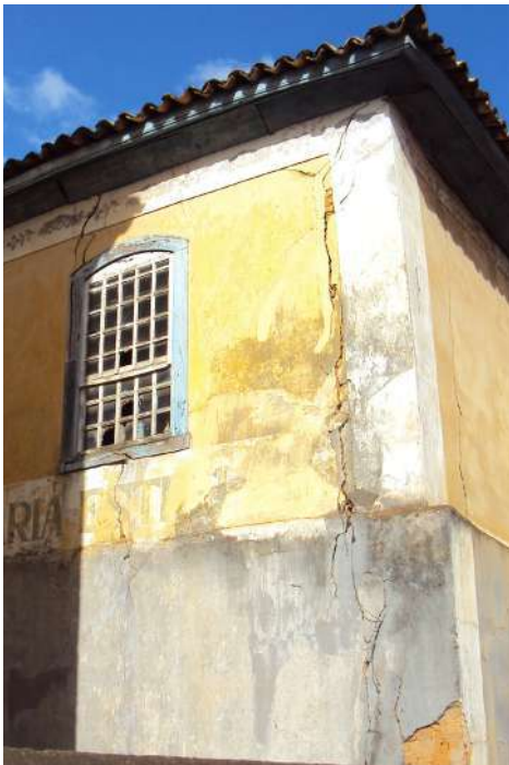
Figura 155 - Rachadura junto ao esteio
