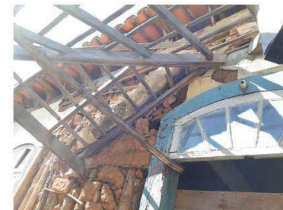
Det 01 - Ausência de telhas
