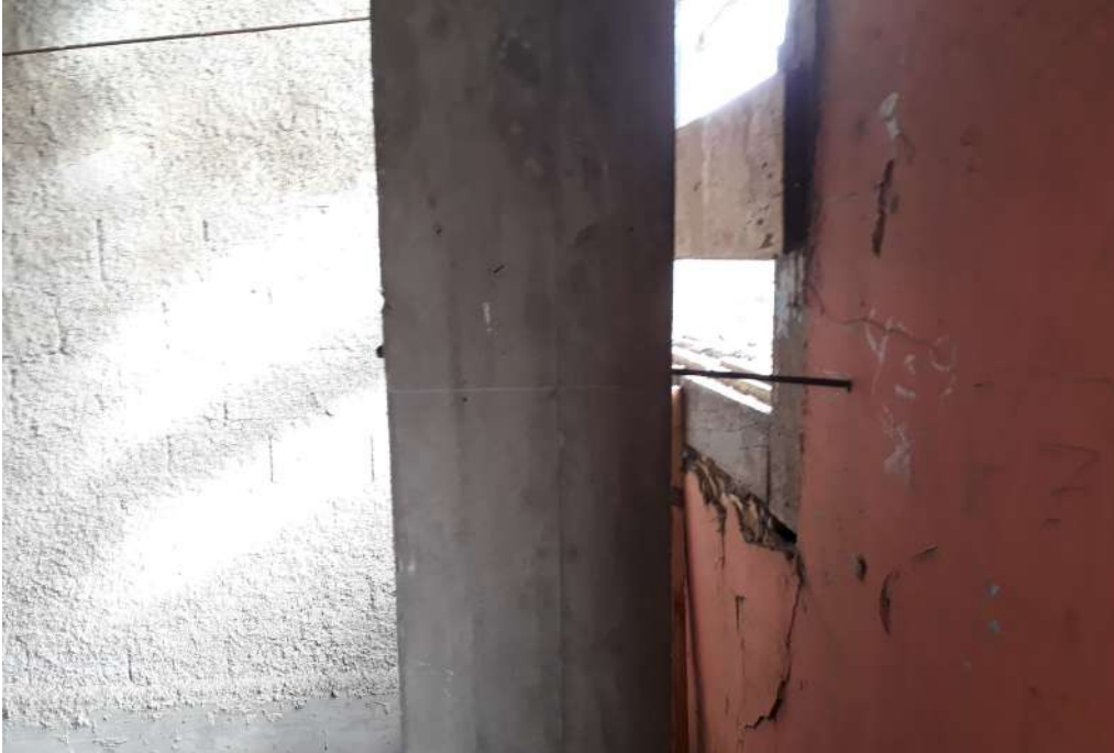
Caderno 2 Foto 52: Detalhe do tirante parafusado no pilar de concreto. Neste ponto em específico o pilar não toca a parede.
