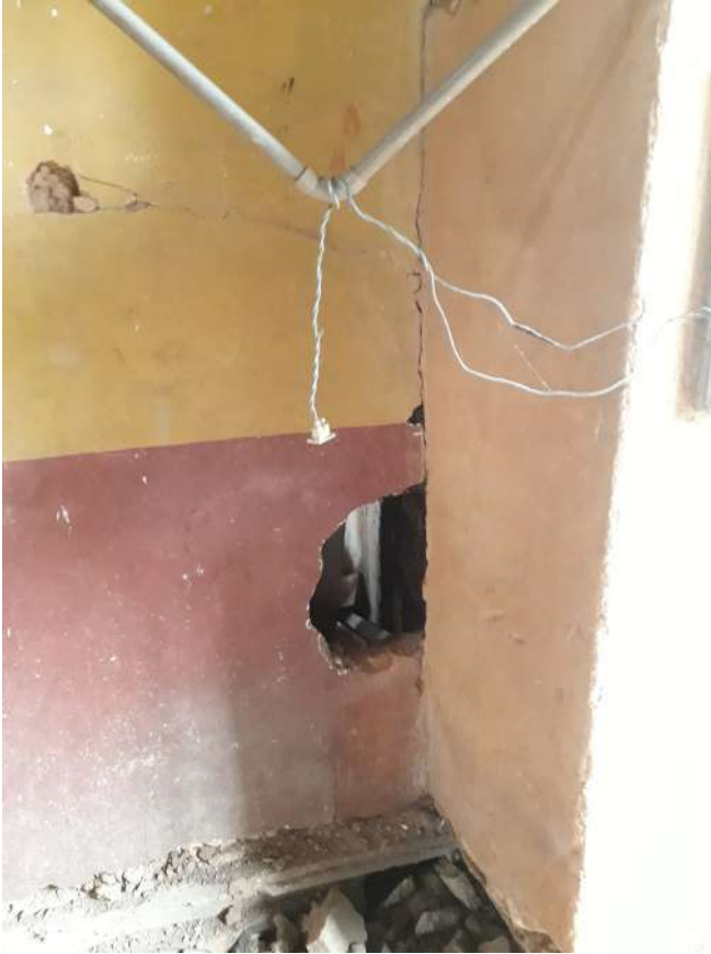
Caderno 2 Foto 60: Buraco na parede em adobe e instalações elétricas improvisadas
