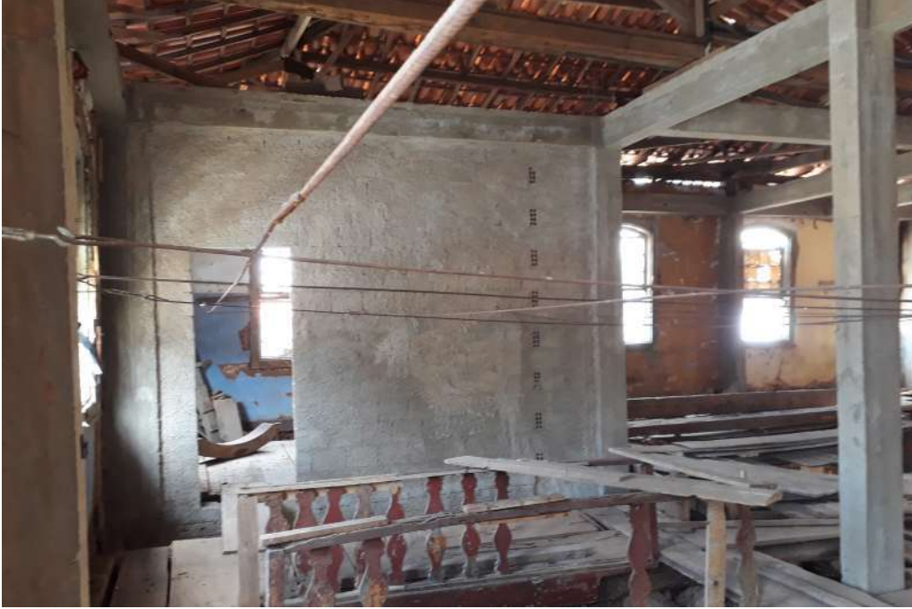
Caderno 2 Foto 39: Intervenção espúria no pavimento superior.
