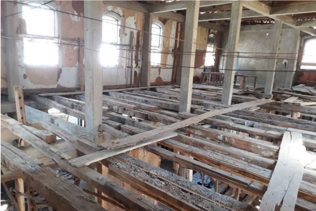
Caderno 2 Foto 38: Vista do primeiro Pavimento. Aos fundos paredes er- guidas em tijolos furados ao fim do ano de 2015
