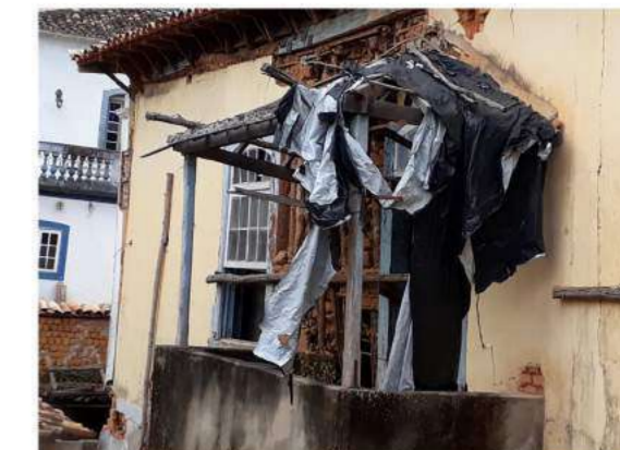
F1 - Ausência de telhas
