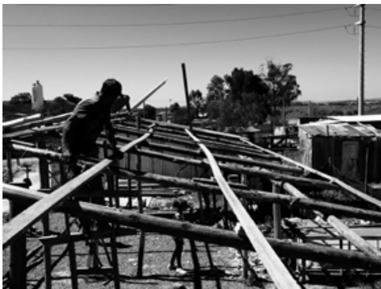
Figura 3 - Mutirão de construção do barracão, ocupação Povo Sem Medo de Porto Alegre, Parte III.
