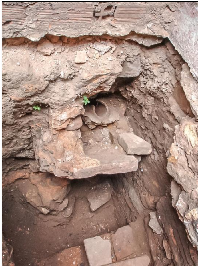
Figura 53: Galeria na Área 8 para escoamento de esgoto domiciliar para o cano geral no grotão
