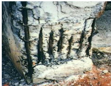
Desagregação do concreto. Recife-PE. Fotografia: Luís Gustavo Costa.
