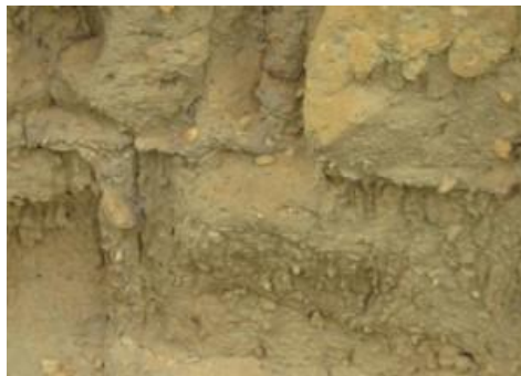
Desagregação do adobe. Casario de Rio de Contas - BA. Fotografia: Luís Gustavo Costa.
