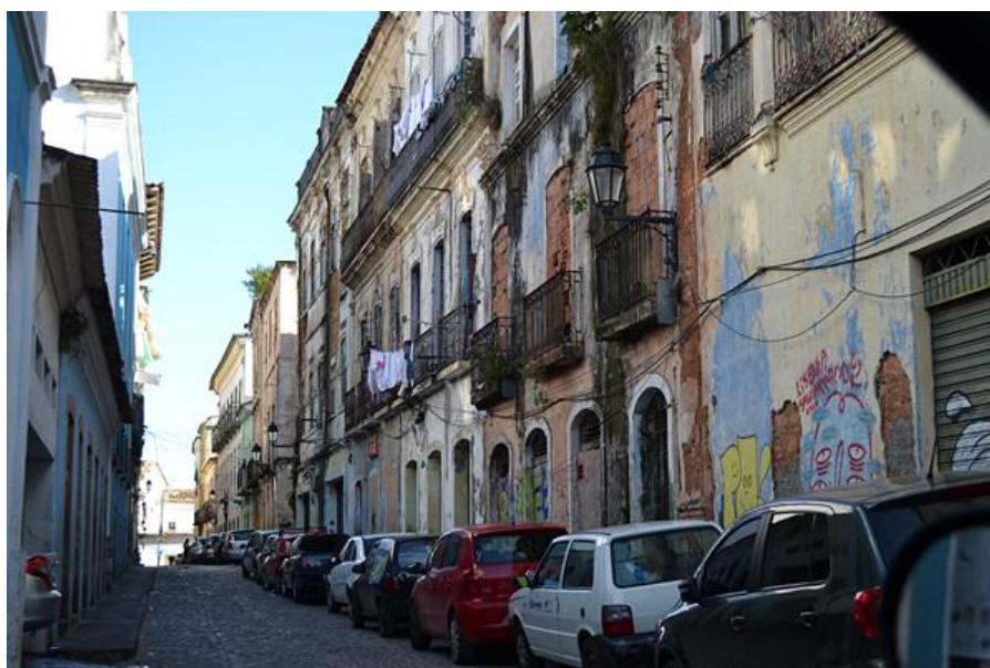
Figura 77 - Casarões abandonados no Centro Histórico de Salvador.
