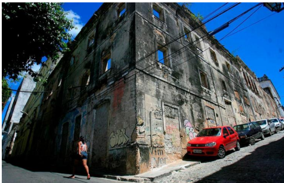
Figura 80 - Casarão abandonado no Centro Histórico de Salvador (b).
