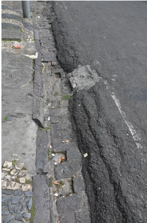
Figura 18 - Palimpsesto asfáltico, Ladeira da Praça, Salvador - BA, 2016
