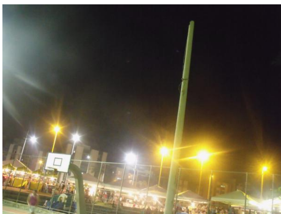
Foto 1 – Poste de iluminação
