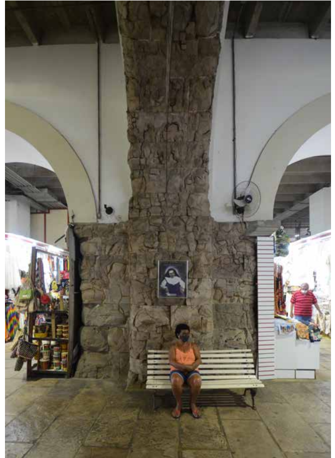
Figura 81 Detalhe do arco de pedra com as marcas dos danos causados pelo incêndio Fonte: Rodrigo Baeta (2020).
