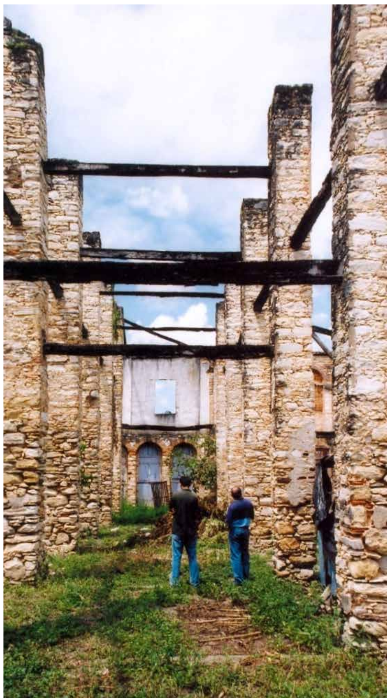
Figura 438 Pilares de pedra do interior do Trapiche Santo Antônio vistos em direção à fachada principal, voltada para a Praça Samuel de Oliveira Fonte: Rodrigo Baeta (2003).
