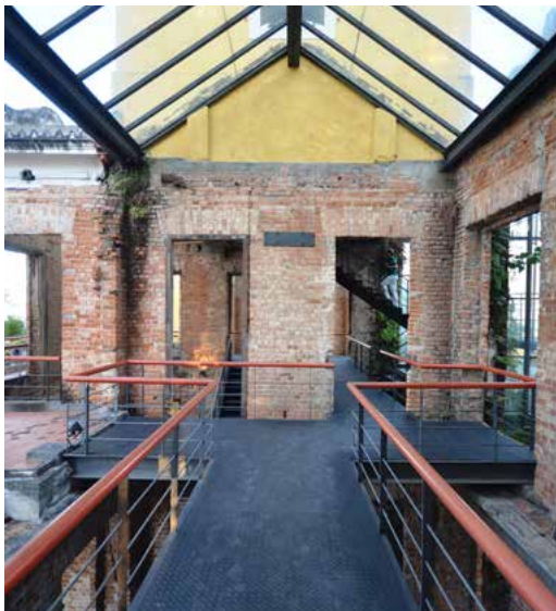
Figura 120 Um dos braços da cruz grega que compõe o partido do palacete arruinado, coberto com telhado de vidro. Reparar a passarela que vem da Chácara do Céu e adentra a ruína Fonte: Rodrigo Baeta (2014).
