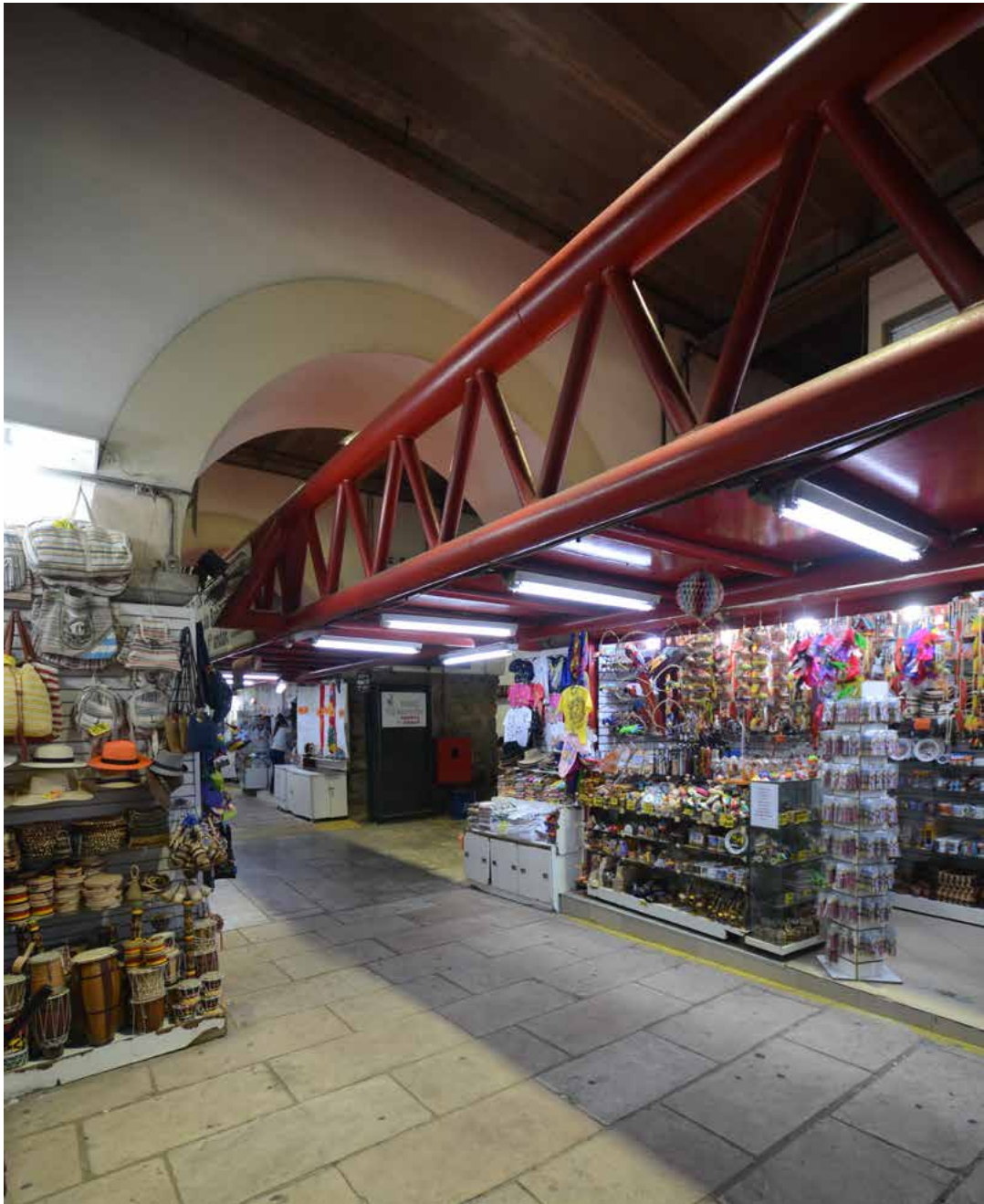
Figura 82 Passarela metálica do Mercado Modelo requalificado Fonte: Rodrigo Baeta (2020).
