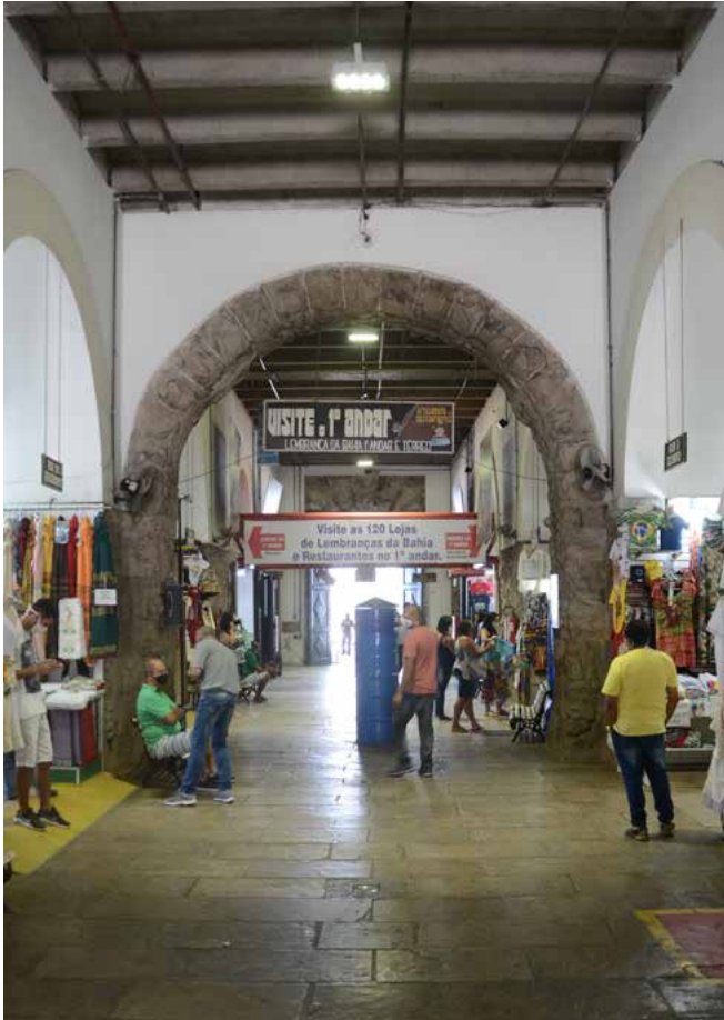
Figura 80 Térreo do Mercado Modelo requalificado, com destaque para o arco de pedra com as marcas dos danos causados pelo incêndio Fonte: Rodrigo Baeta (2020).
