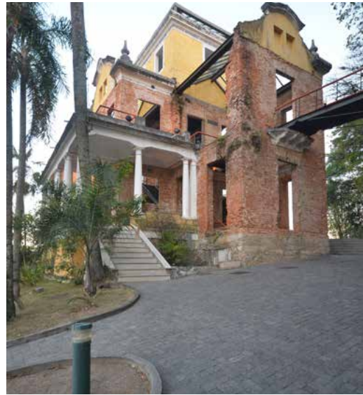
Figura 119 Paredes arruinadas (descascadas) na volumetria exterior do Palacete Murtinho Nobre – Parque das Ruínas. A passarela leva ao Museu da Chácara do Céu Fonte: Rodrigo Baeta (2014).
