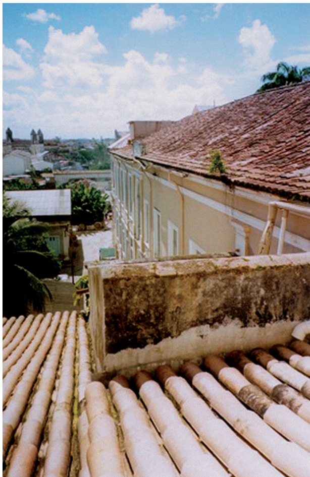
FIGURA 49. Antiga Faculdade de Medicina, fachada para a Baía de Todos os Santos, em restauração. Fotógrafo: Ubirajara Dantas Lemos.
