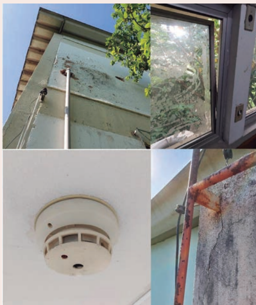
Figura 3. Sistemas construtivos com falhas de manutenção.
