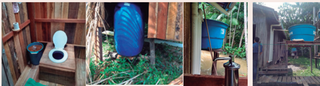
Figura 3. Banheiros secos e captação de água de chuva. Ilha das Onças, Belém - PA.
