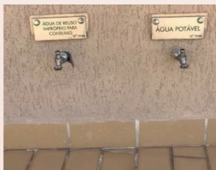
Figura 7. Torneiras da área comum com a qualidade da água identificada: edifício BI.
