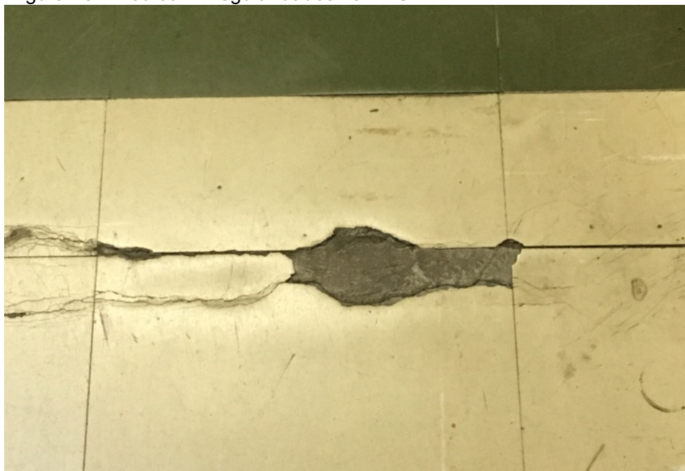
Figura 13 - Piso com irregularidades na EAUFBFA
