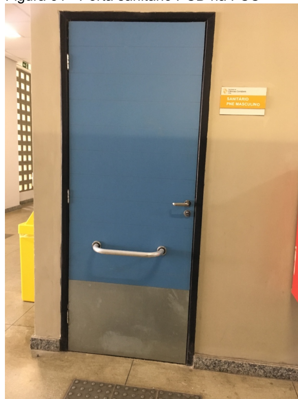
Figura 31 - Porta sanitário PCD na FCC
