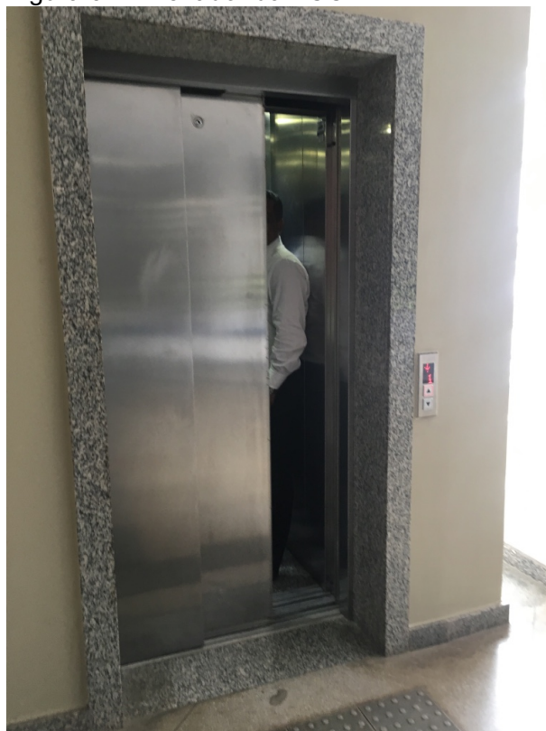
Figura 32 - Elevador da FCC
