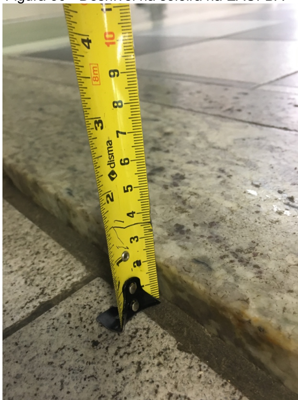
Figura 30 - Desnível na soleira na EAUFBA
