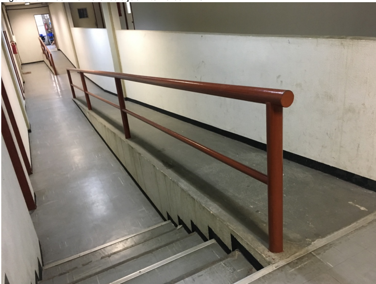
Figura 15 - Desnível na circulação interna da FACED
