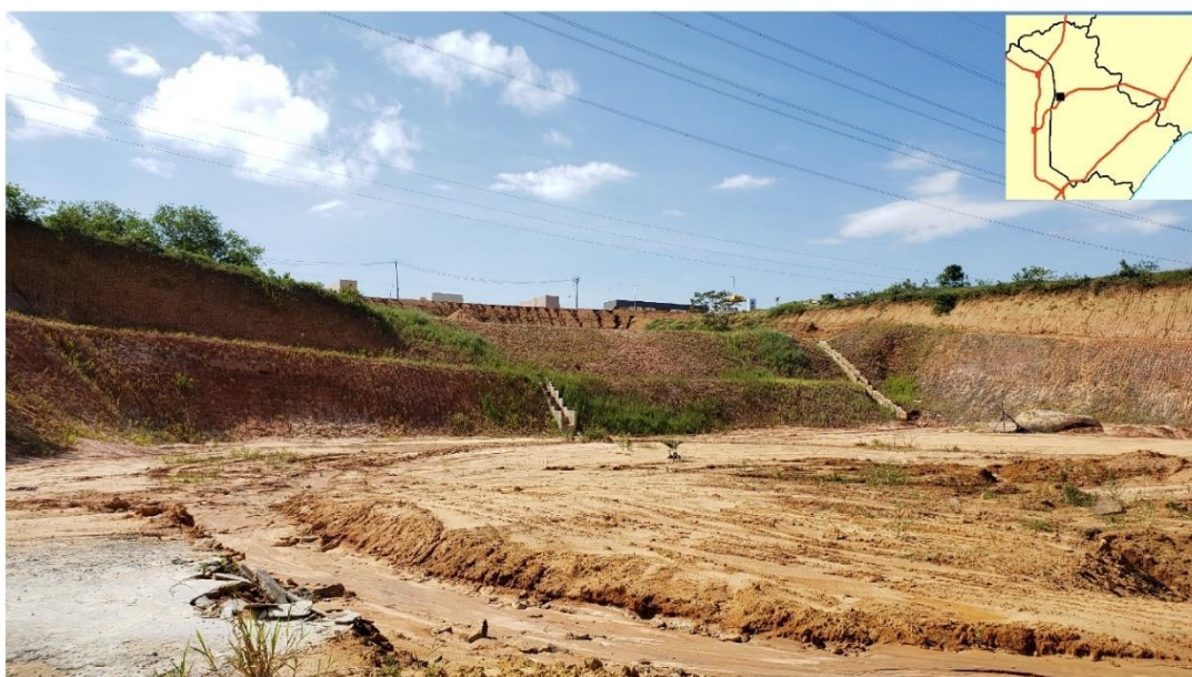
Figura 101 – Área de nascente e app de 30 metros com solo exposto para construção civil para implantação de um posto de combustível em Lauro de Freitas, no sentido para Salvador na via Metropolitana, em 13/02/2020
