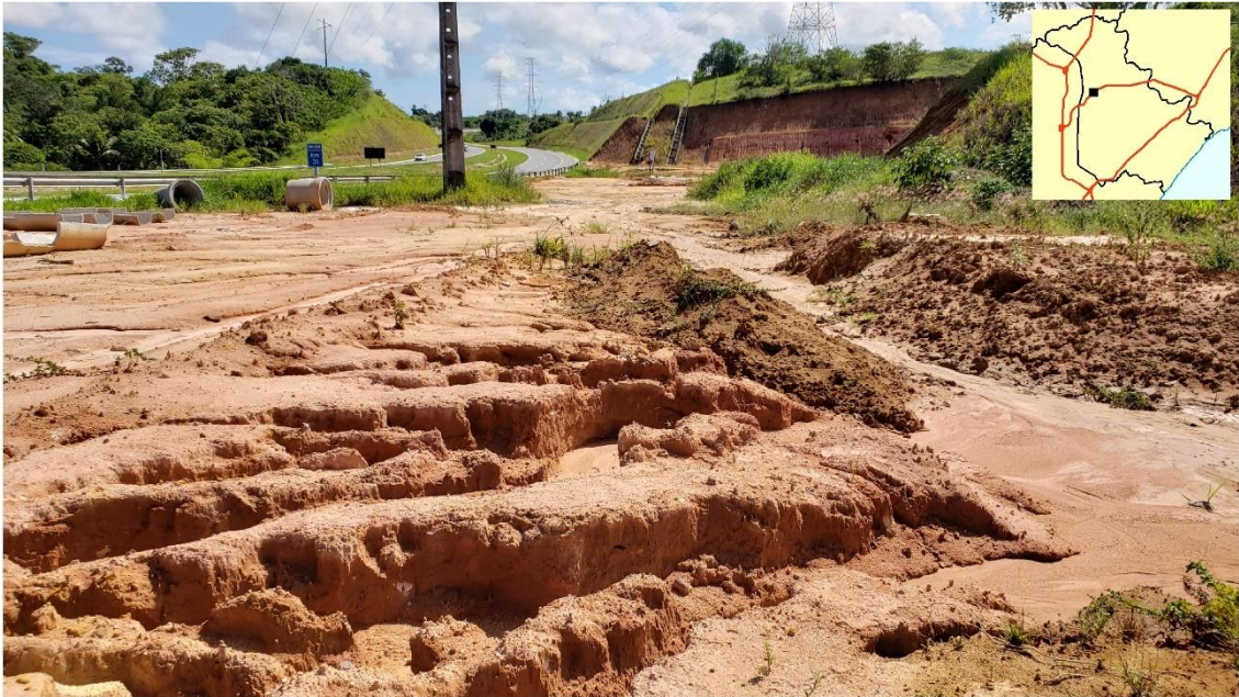
Figura 112 – Área de solo exposto para construção civil para implantação de um posto de combustível, próxima da app de curso d'água de 30 metros, no sentido para Salvador na via Metropolitana em Lauro de Freitas, em 13/02/2020
