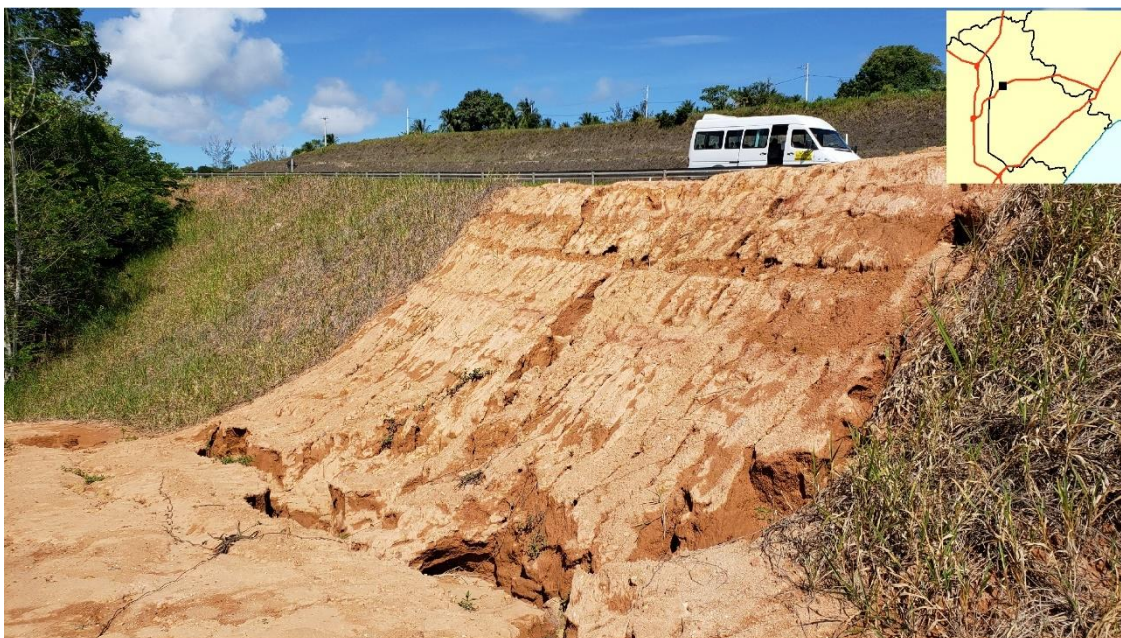
Figura 109 – Área de solo exposto para construção civil para implantação de um posto de combustível, próxima da app de curso d'água de 30 metros, no sentido Salvador na via Metropolitana em Lauro de Freitas, em 13/02/2020
