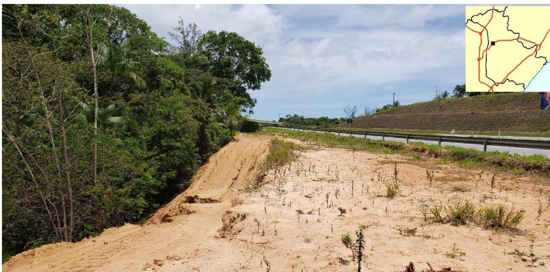
Figura 111 – Área de solo exposto para construção civil para implantação de um posto de combustível, próxima da app de curso d'água de 30 metros, no sentido para Salvador na via Metropolitana em Lauro de Freitas, em 15/11/2020
