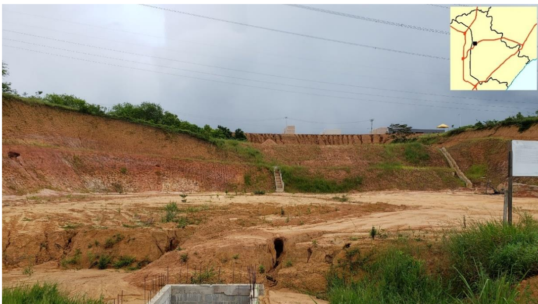
Figura 102 – Área de nascente e app de 30 metros com solo exposto para construção civil para implantação de um posto de combustível, em Lauro de Freitas, no sentido para Salvador na via Metropolitana, em 29/02/2020
