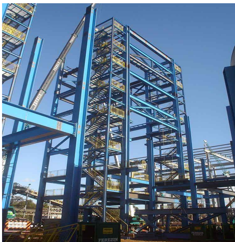
Figura 2 – Prédio de caldeiras – COSAN - Petrobras
