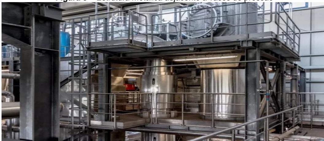
Figura 3 – Estrutura metálica adjacente a vasos de pressão
