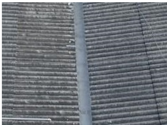
(a) Exemplo de imagem da classe de telhado com calha íntegra e limpa.
