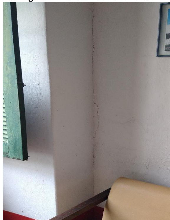
Figura 28- Fissura entre alvenarias
