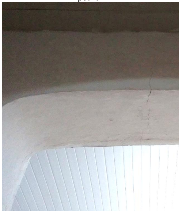
Figura 27- Fissura no arco de alvenaria de pedra
