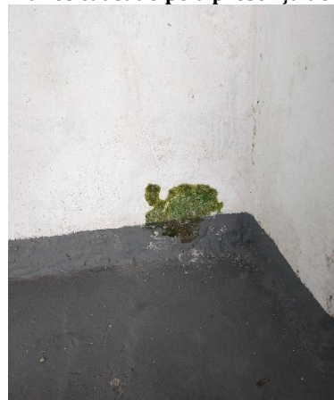
FOTO 112: Danos causado pela presença de água no muro
