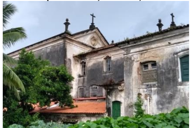
Figura 127- Fachada sudeste da Igreja de N. S. da Lapa e intervenções sobre janelas
