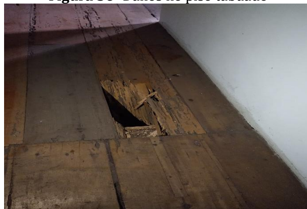
Figura 36- Danos no piso tabuado
