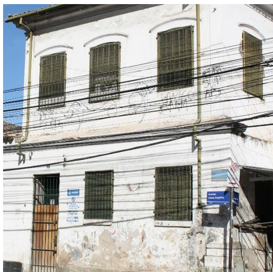
Figura 104- Vandalismo na fachada
