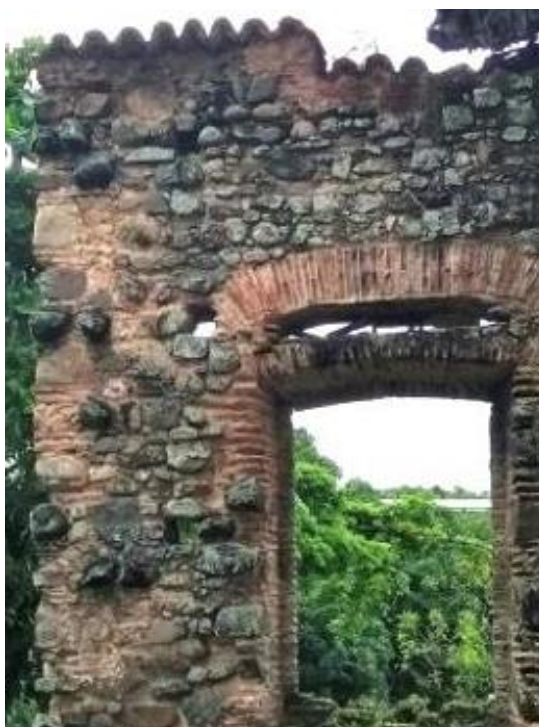
Figura 21- Trecho em ruína de alvenaria de pedra aparente
