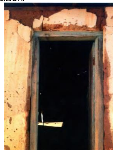
b) Porta da Moradia Degradada, Disponibilizada para o Trabalhador na Fazenda Lagoa do Severiano.
