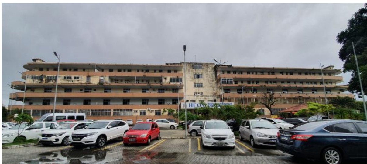
Figura 338 – Fachada principal do HEOM e suas alterações: fechamentos, pastilhas, instalações aparentes e ampliação da área de estacionamento.
