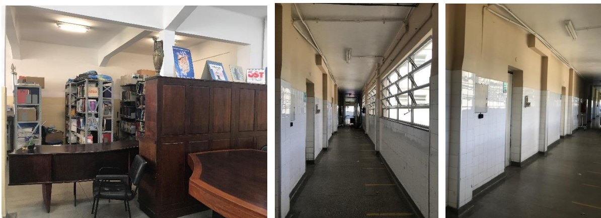
Figuras 178, 179 e 180 – Encontro da estrutura aparente na Biblioteca, no 1º pavimento (à esquerda); laje em balanço na circulação de distribuição entre as enfermarias do primeiro pavimento (ao centro); shafts desalinhados com a estrutura dos pilares e vigas, contíguos à parede das enfermarias, localizados na circulação posterior do hospital para distribuir as tubulações hidrossanitárias dos banheiros dos últimos pavimentos (à direita).
