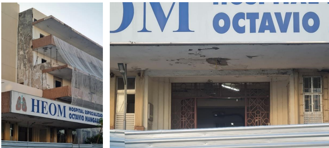
Figuras 415 e 416 – Laje da varanda do 4º pavimento escorada (à esquerda); o portão de ferro original se encontra no mesmo local (à direita).
