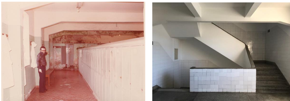
Figuras 176 e 177 – Vigas com aumento de seção da extremidade onde encontram os pilares (à esquerda); estrutura no hall central de circulação (à direita).
