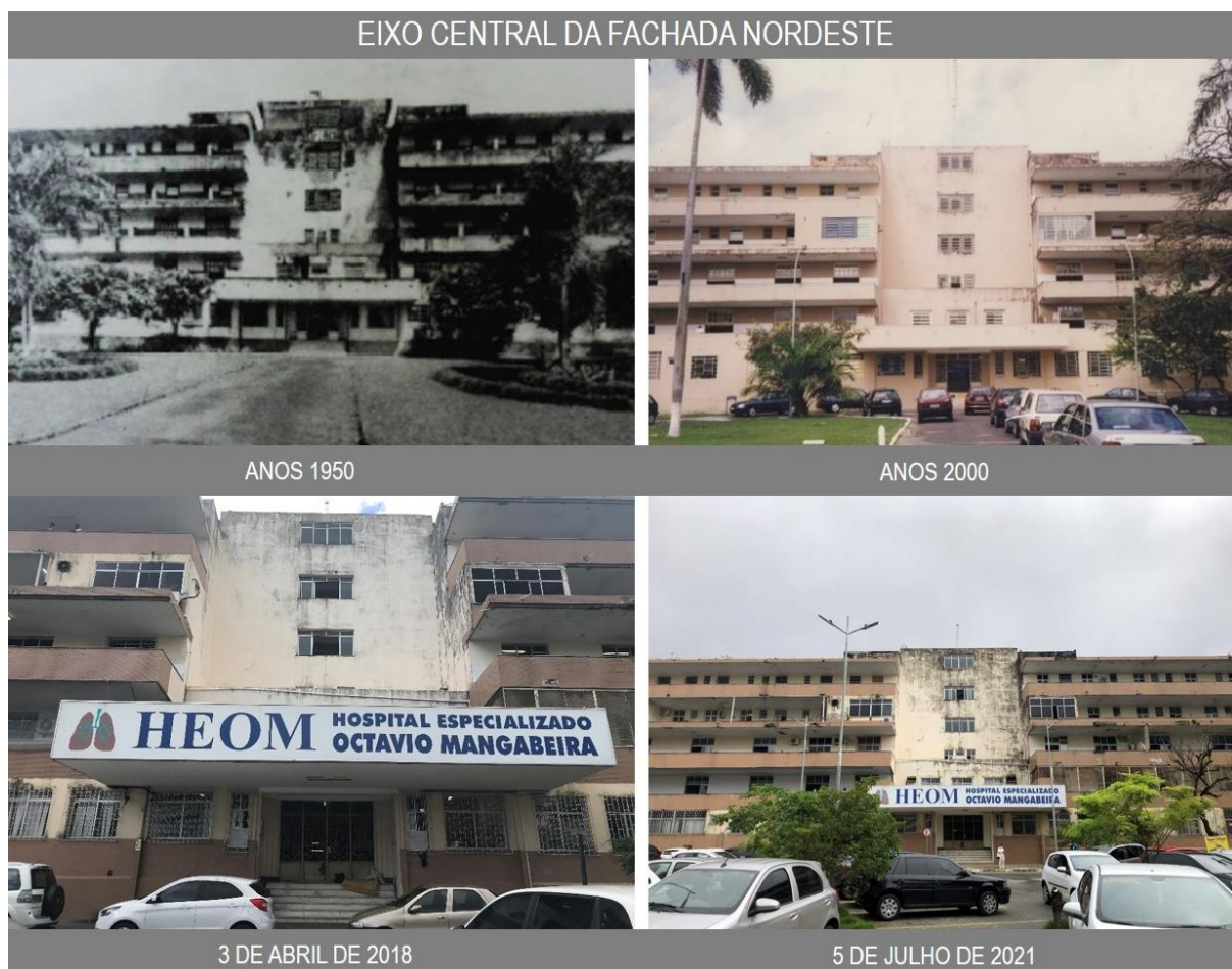
Figura 335 – Alterações no eixo central: sinalização na marquise, volume da cobertura e sujidade.
