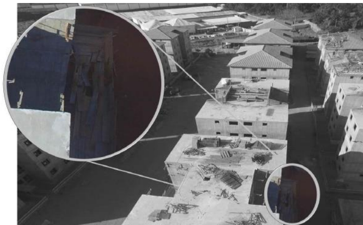
Figura 17 - Exemplo de plataforma primária com falhas na forração do piso
