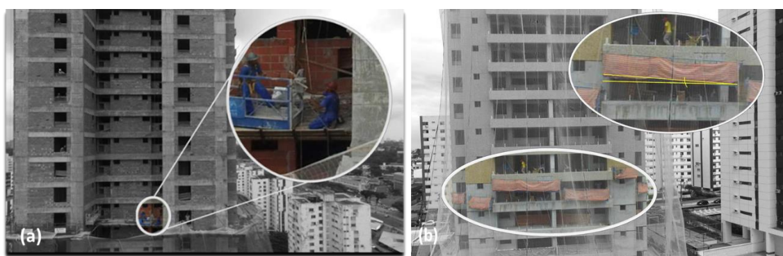
Figura 18 - Itens avaliados: (a) sobrecarga na plataforma e (b) andaime suspenso desnivelado
