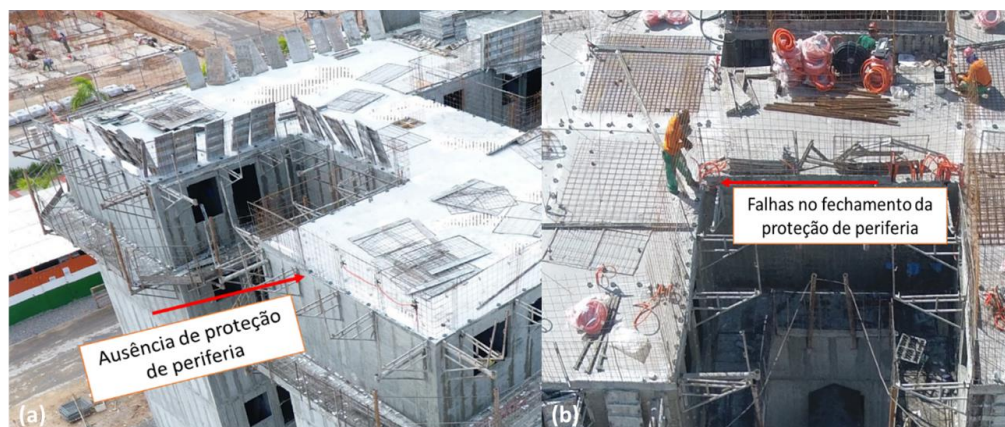
Figura 54 - Ausência ou falhas no fechamento da proteção de periferia (Situação 01)
