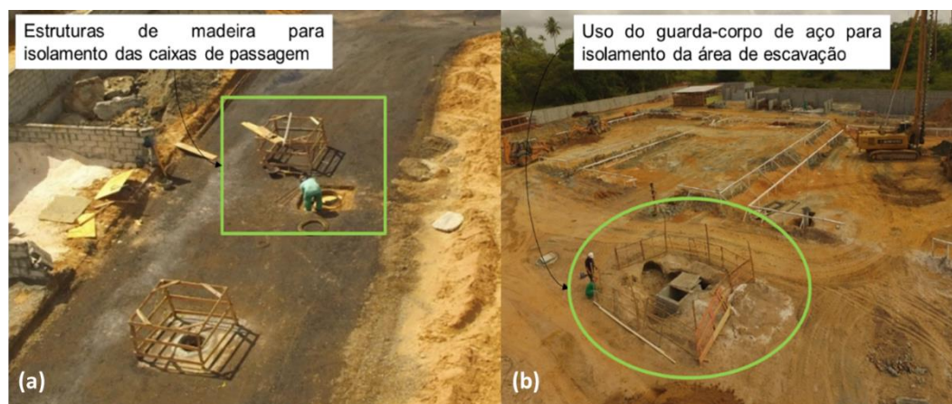
Figura 39 - Substituição de materiais: (a) estruturas de madeira e (b) guarda-corpo de aço
