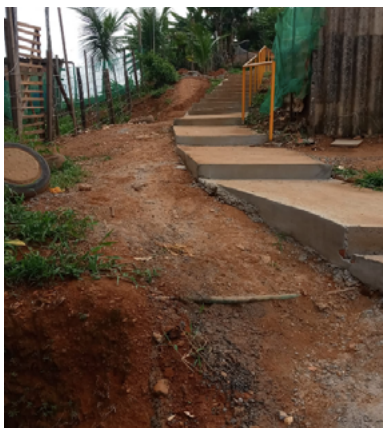
Figuras 84 e 85: Construção de escadaria pela Prefeitura Municipal de Salvador, no percurso original da trilha -escada-parque, 2023
