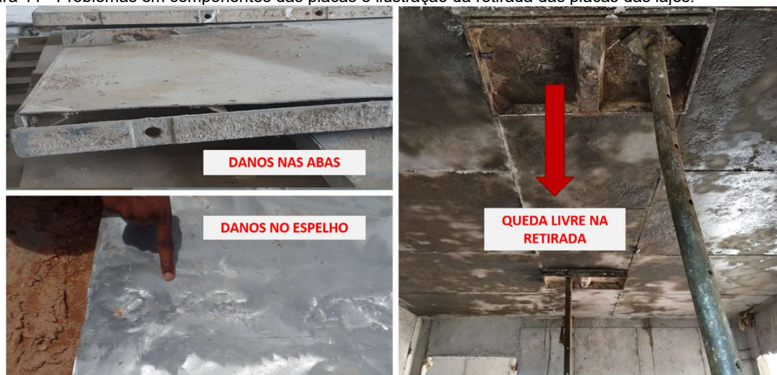
Figura 44 - Problemas em componentes das placas e ilustração da retirada das placas das lajes.
