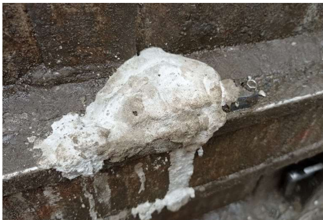
Figura 77 - Tag parcialmente coberta de concreto.
