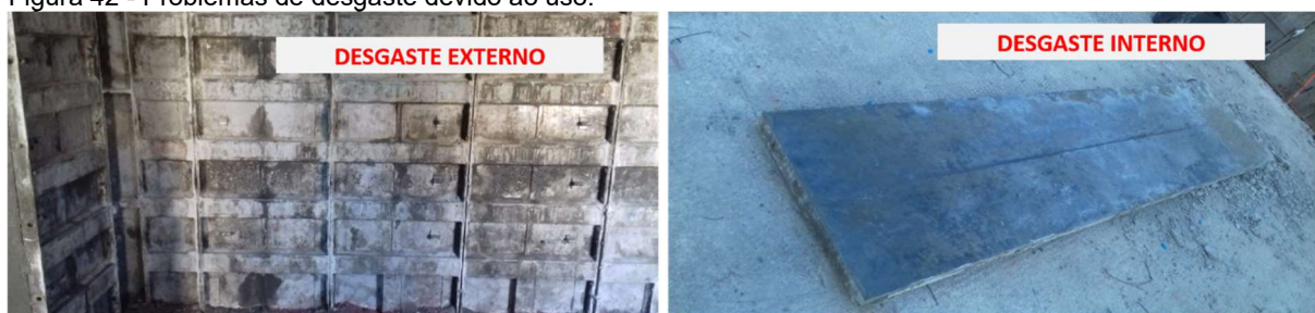
Figura 42 - Problemas de desgaste devido ao uso.
