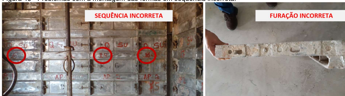
Figura 43 - Problemas com a montagem das formas em sequência incorreta.
