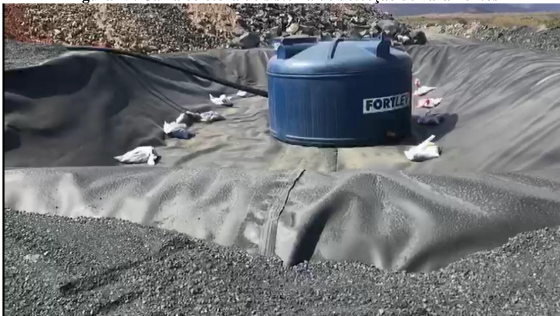
Figura 19. Caixa coletora do sistema de detecção de vazamentos
