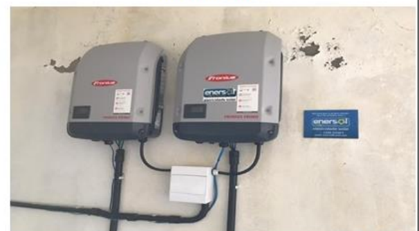
Figura 19: Inversores FV sem Presença de Sujidade
