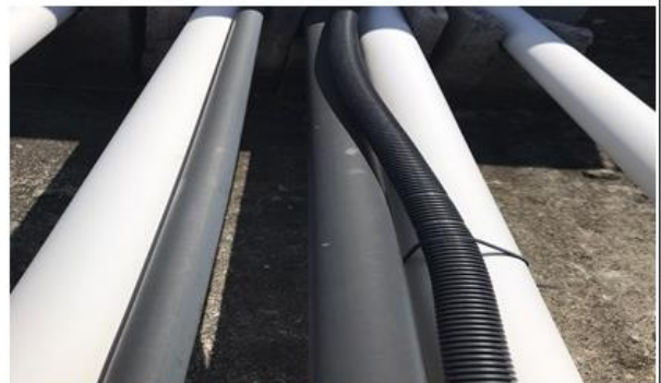
Figura 15: Condutores de CC e Aterramento, Mangueiras com Cabeamento de Rede e Eletrocalhas.
