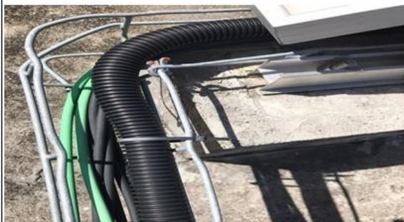
Figura 16: Eletrodutos com Condutores de CC e Aterramento e Mangueiras com Cabeamento de Rede.
