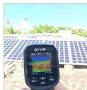
Figura 21: Inspeção Termográfica dos Módulos FV. Fonte: Próprio Autor (Outubro/2020).
