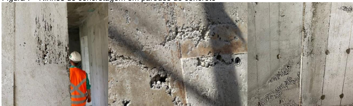
Figura 7 - Ninhos de concretagem em paredes de concreto
