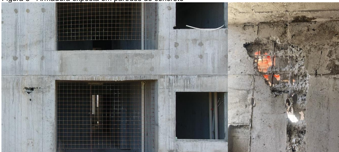
Figura 8 - Armadura exposta em paredes de concreto
