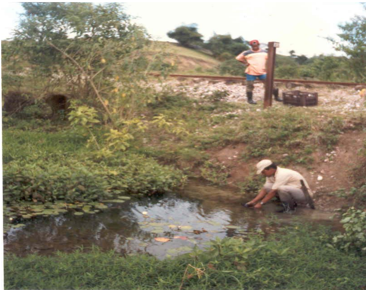
Foto 8.4 - Surgência das águas provenientes da tubulação (noroeste da foto) que passa abaixo da ferrovia e são oriundas da pluviometria e águas acumuladas a montante do barramento da escória.
