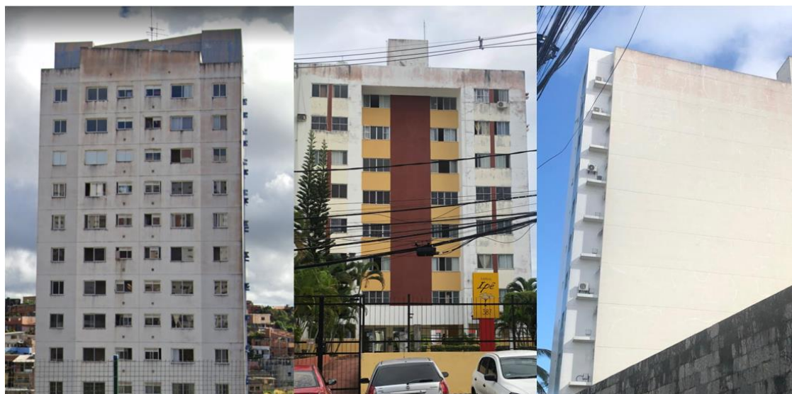
Figura 42 – Concentração das manchas vermelhas nos pavimentos superiores
