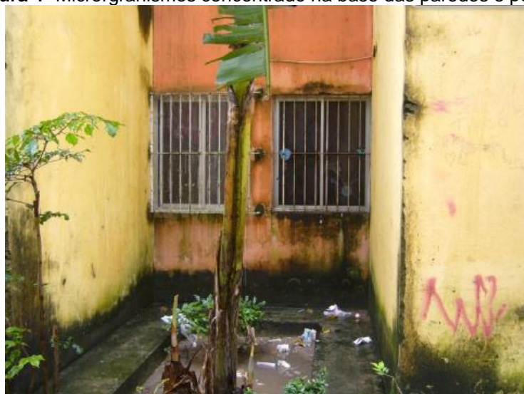
Figura 4- Microorganismos concentrado na base das paredes e peitoril
