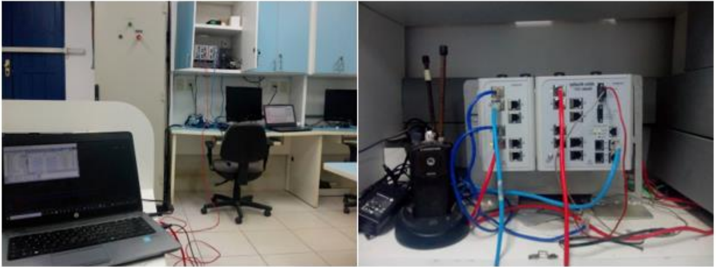
Figura 22: Parte do hardware utilizado.
