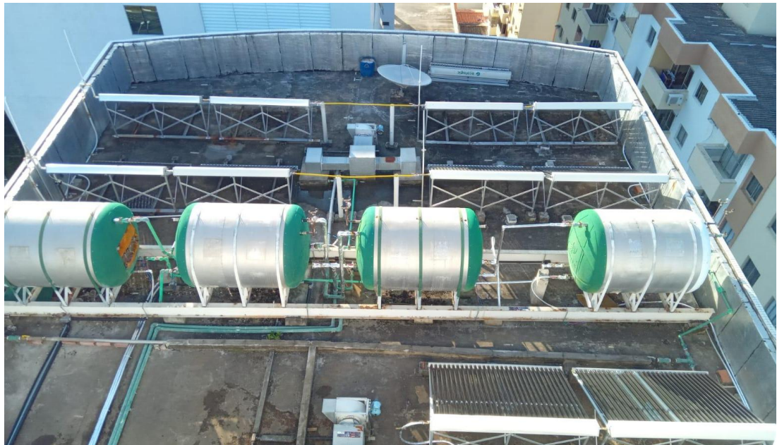
Figura 15- SAS em um hotel em Lauro de Freitas, Bahia.
