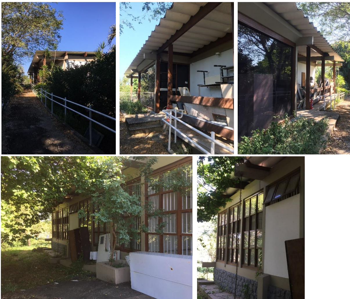
Figura 122, 123, 124, 125 e 126: Fotografias recentes do Edifício Catetinho, fachada leste (frontal) e fachada sul (lateral), com destaque para as intervenções descaracterizantes. Fonte: acervo pessoal, maio 2021.
