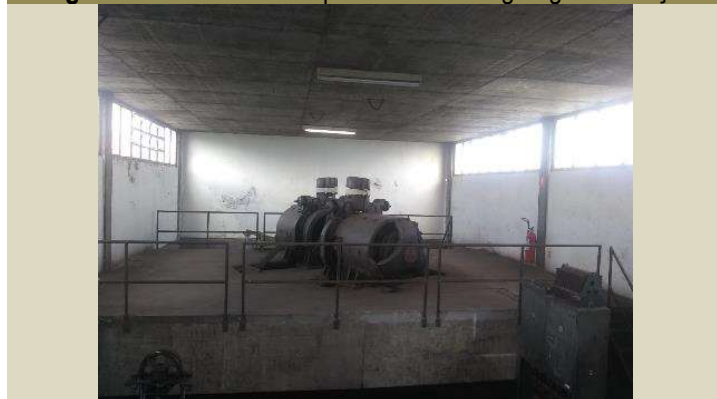
Figura 4.59- Casa de máquina do Edifício-garagem Aliança.
