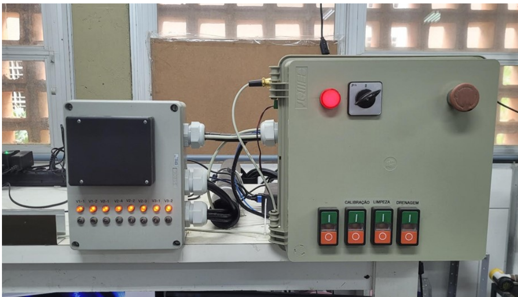
Figura 3.3 Foto dos painéis de controle e sinótico
