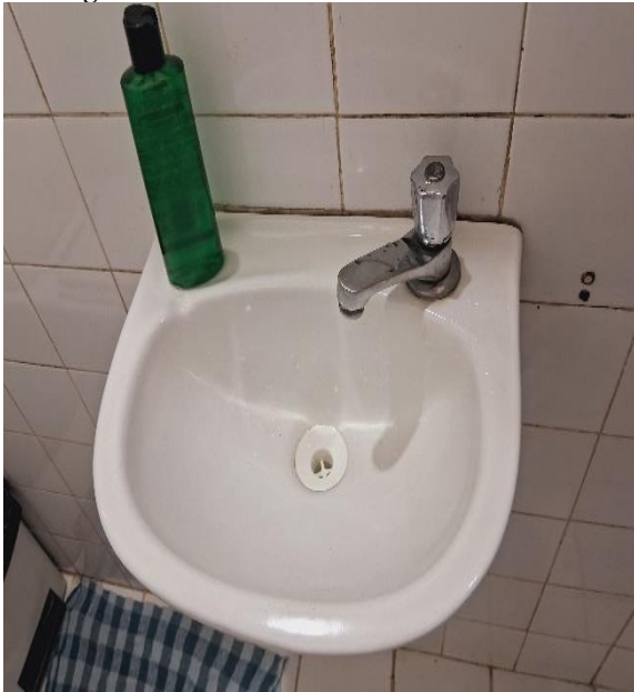
Figura 21 - Torneira do sanitário masculino.
