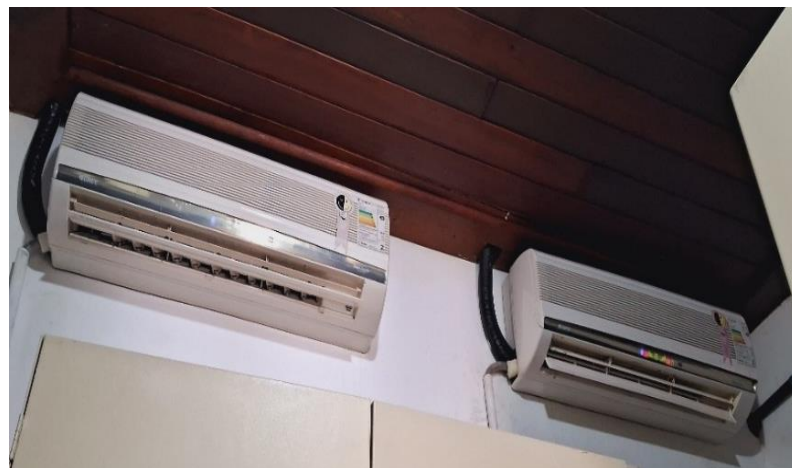
Figura 6 - Ares-condicionados da reserva técnica da instituição.
