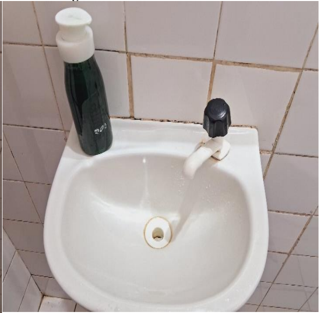
Figura 22 - Torneira do sanitário feminino.
