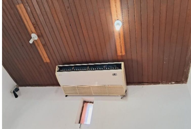
Figura 7 - Ar-condicionado da sala da coordenação.
