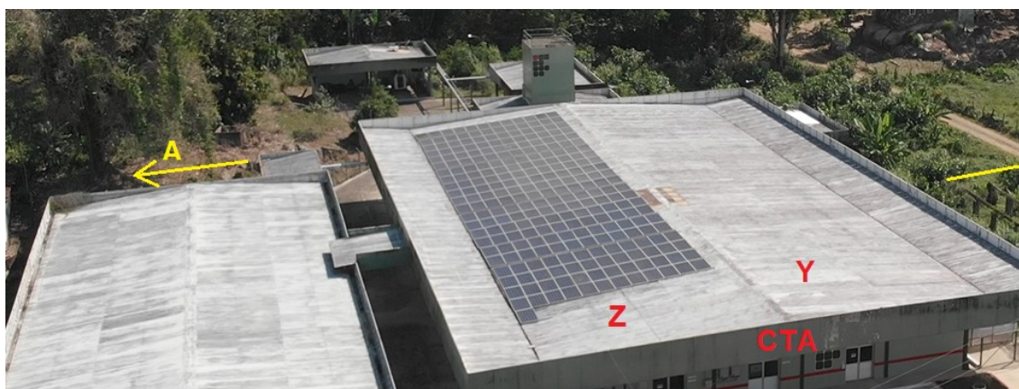
Figura 11: Inclinações e direcionamentos do telhado do CTA. Fonte: Fotografia obtida in-loco através de drone
