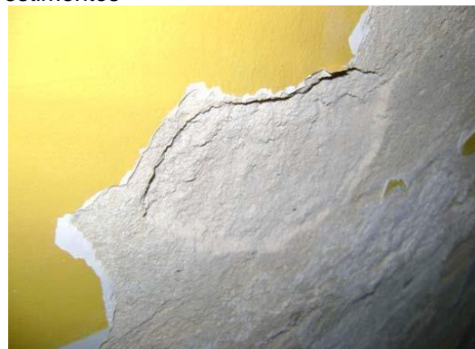
(b) Cavidade formada no revestimento
