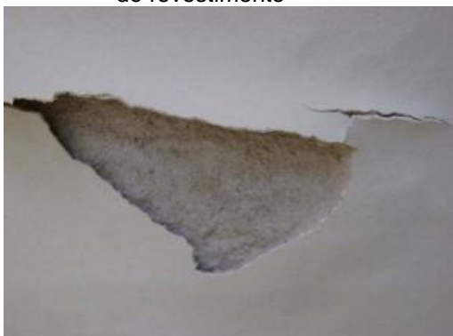
Figura 7- Desagregação com descolamento do revestimento
