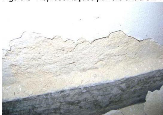
(a) Desagregação da argamassa Fonte: Adaptado de Ferreira (2010).
