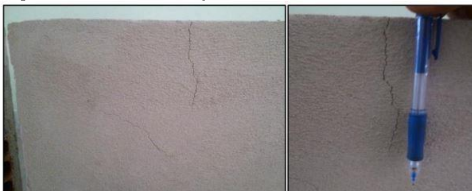
Figura 5- Fissuras devido à retração
