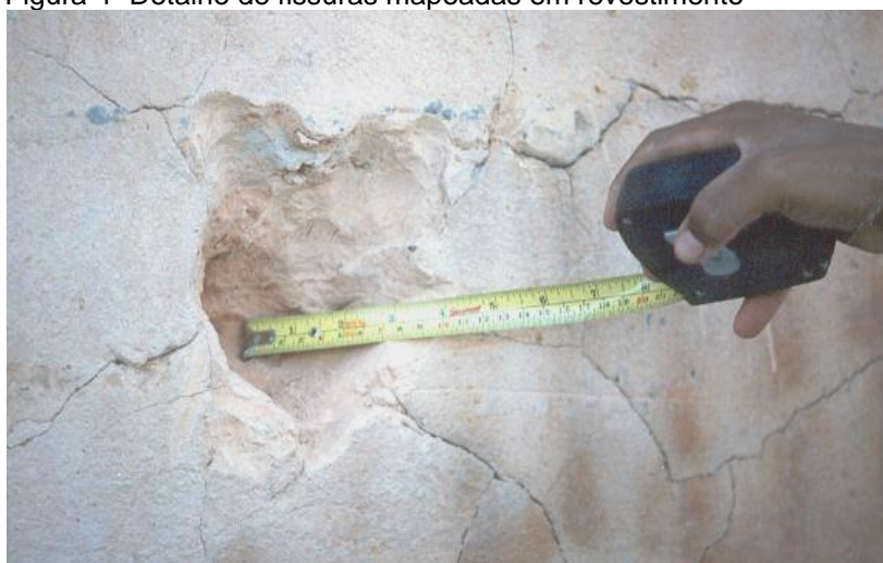
Figura 4- Detalhe de fissuras mapeadas em revestimento
