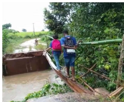
Figura 2 — Estudantes atravessam em ponte improvisada
