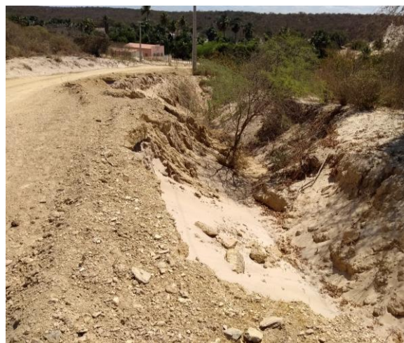
B) Voçoroca por conta da estrada de cascalhos mal planejada sobre as dunas
