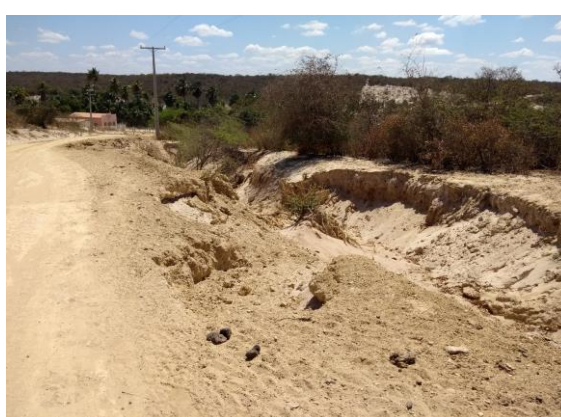
D) Voçorocas na estrada de cascalhos sobre as dunas na BHRI
