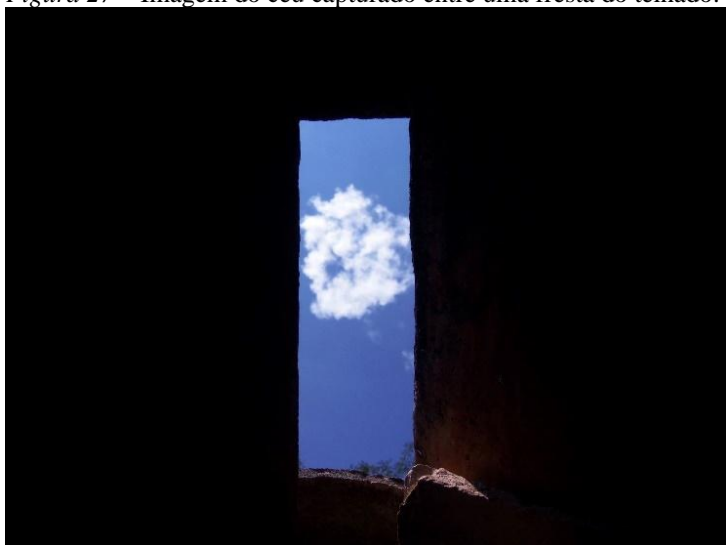
Figura 27 – Imagem do céu capturado entre uma fresta do telhado.
