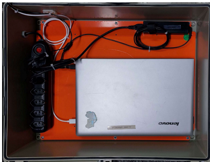
Figura 3.24 Fixação do computador e filtro de linha na caixa de comando elétrico. Fonte: Própria autora.
