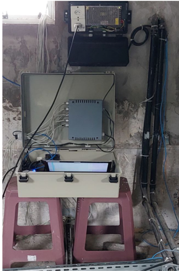
Figura 3.33 Sistema de aquisição de dados acomodado em área coberta. Fonte: Própria autora.
