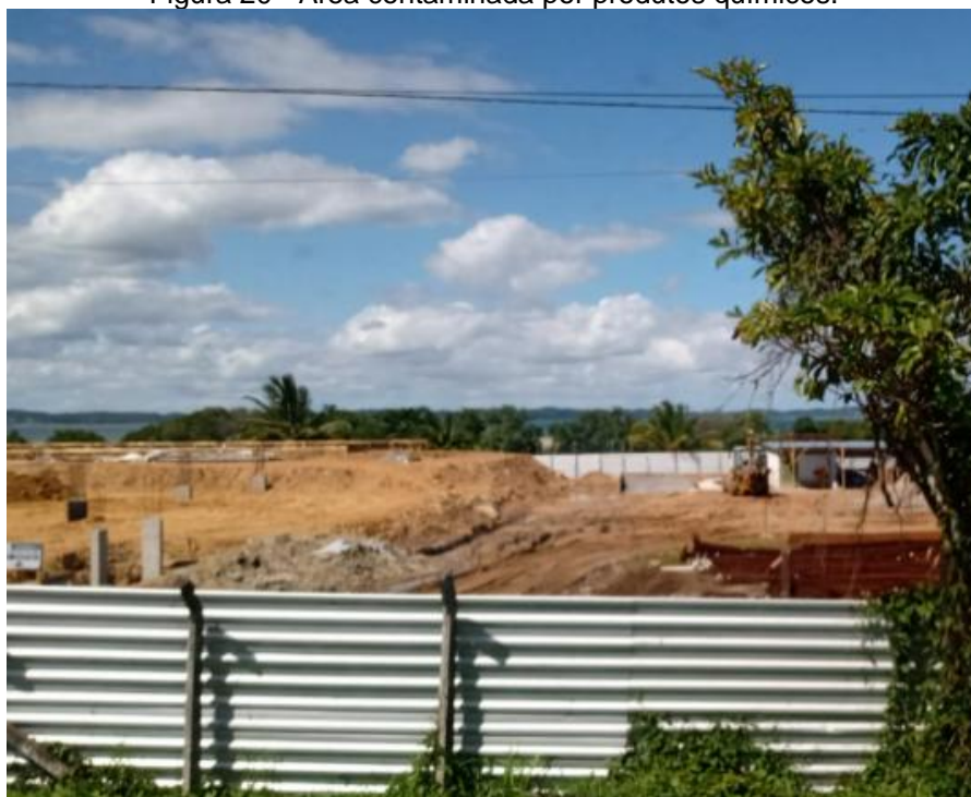
Figura 20 - Área contaminada por produtos químicos.
