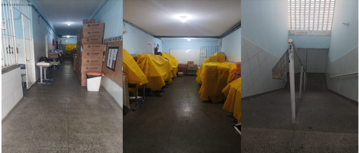
Figura 10 - Imagens da área interna do andar térreo da Escola Municipal Visconde de Cairu.
