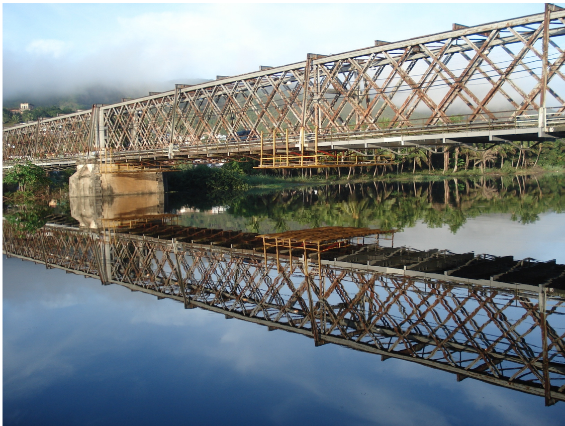
Ponte D. Pedro II sobre o rio Paraguaçu Foto: Nei Budica, fevereiro de 2009.
